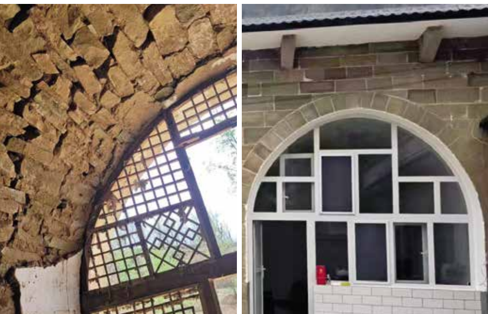
■ 佳县佳州街道史家沟村低保户刘乃生家房屋改造前后对比。
